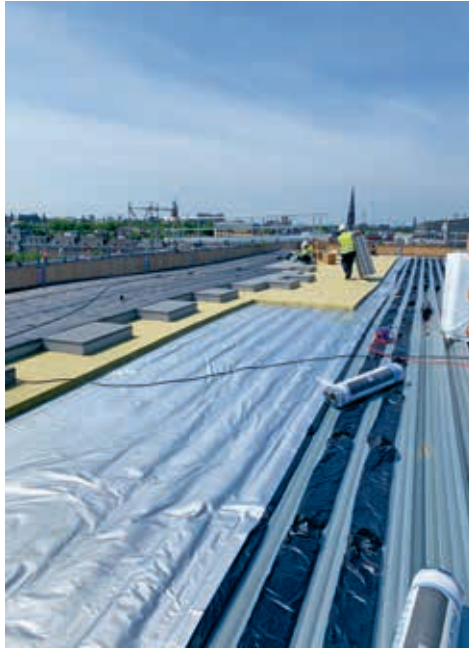
Het dak voor de zonnepanelen kreeg een isolatiepakket (cannelurevulling, steenwol, EPS-isolatie met een brandvertragende toplaag) en twee lagen bitumen. (Foto: Kuijpers)
