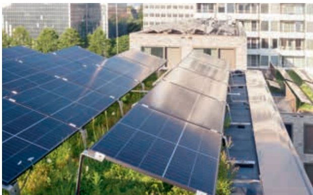
PV-panelen in een zuidopstelling opgetild boven een blauwgroen dak. (Foto: Sem Langendijk)
