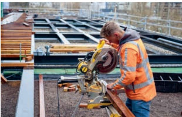
Aanleg vlonders. De stalen onderconstructie is hier goed zichtbaar. (Foto: Jan van der Ploeg)
